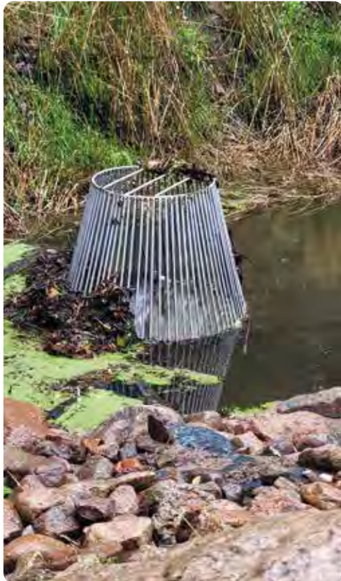
03. August 10:56 Uhr: Am Einlass zur Straßenunterführung staut sich das Wasser der Burgberggrabens.
