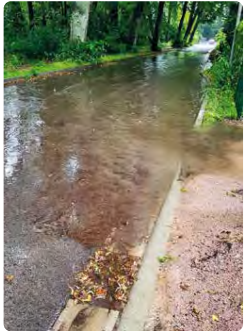
03. August 12:55 Uhr: Das Regenwasser läuft an der tiefsten Stelle des Bergedorfer Weges zusammen, weil auf beiden Seiten noch Sieleinläufe fehlen.
